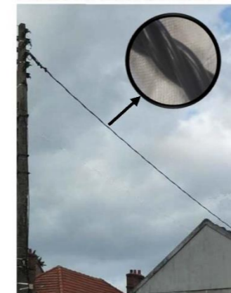
Réseau fils isolés aérien BT
