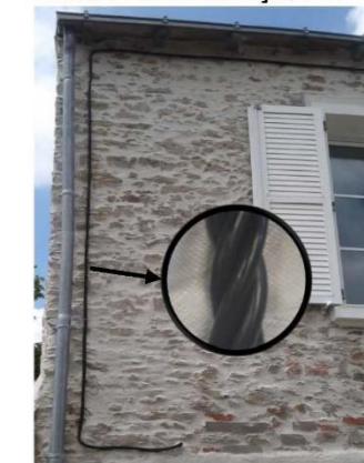
Réseau fils isolés façade BT
